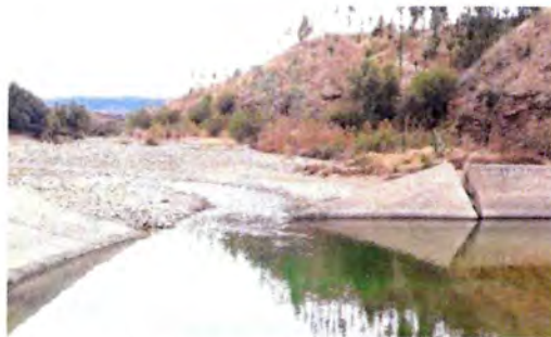
Obra de toma de agua para riego de papa, maíz y hortalizas.
