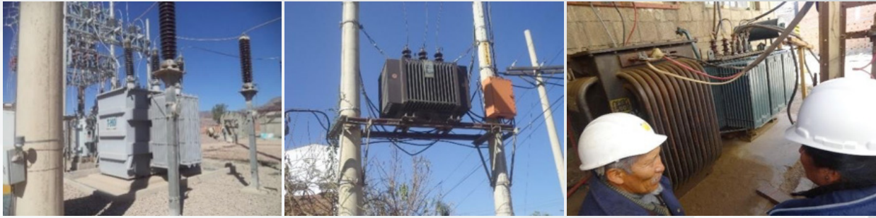
Fotografía 5. Existencias con PCBs en Operación
