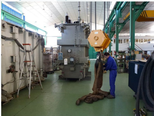
Fotografía 6. Recepción de un Transformador
