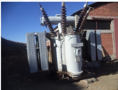
Imagen 1. Transformador de COMIBOL - Machacamarca
