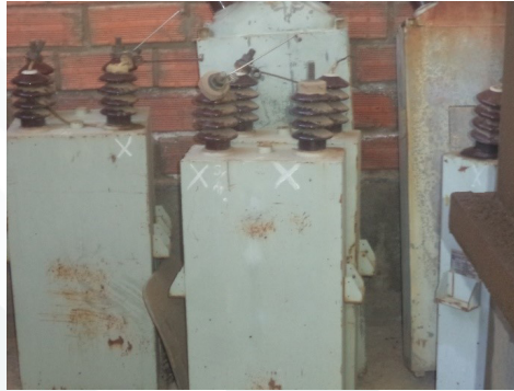
Imagen 2. Transformador de COMIBOL - Machacamarcá
